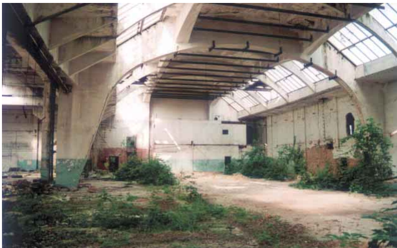
Hala č. 38 s architektonicky hodnotnou konstrukcí, avšak v havarijním stavu; zde umístěná galvanovna byla nejvýznamnějším původcem ekologických škod
